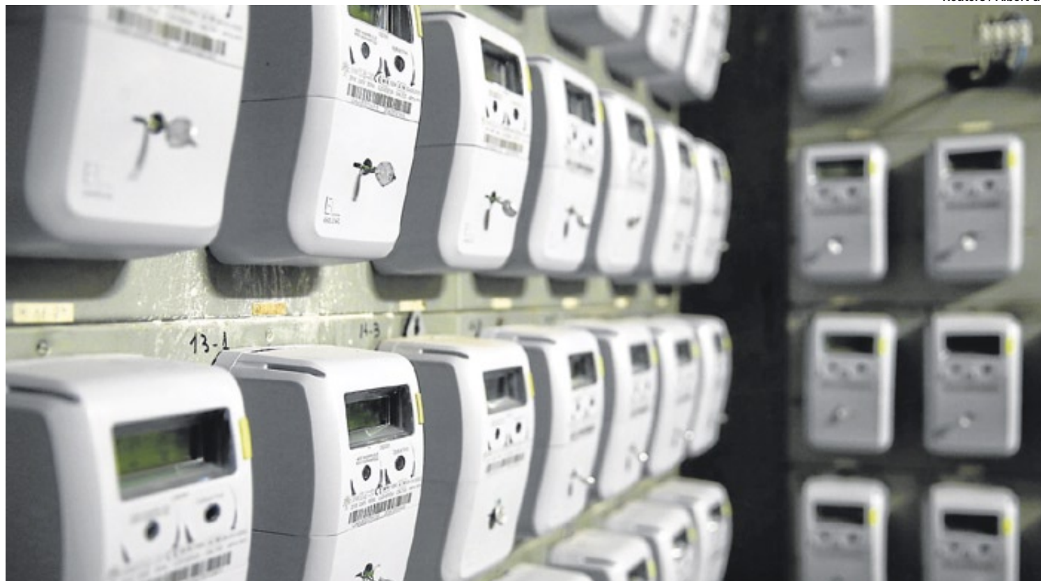
Contadores de luz. Aparatos para medir el consumo de electricidad en las casas de un edificio.
